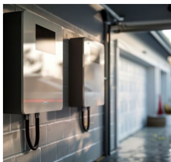
Balkonkraftwerk und Batteriespeicher
