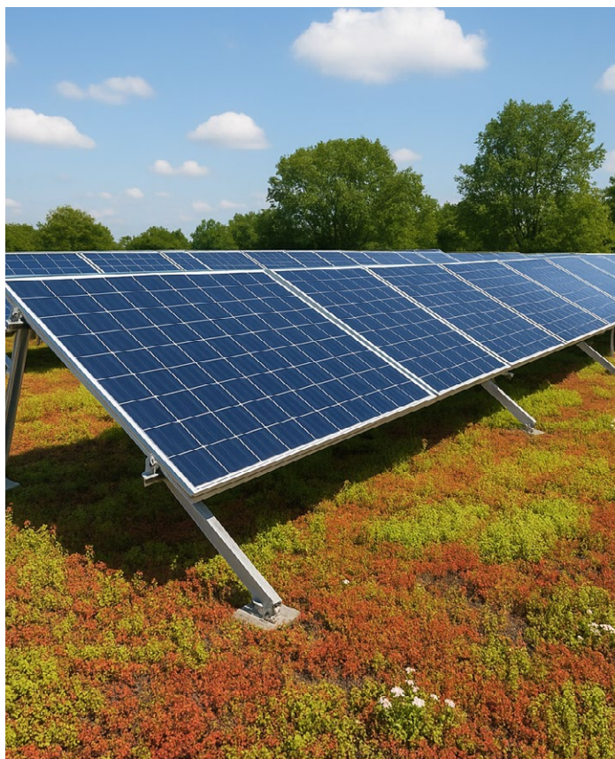
Photovoltaikanlage auf einem Gründach
